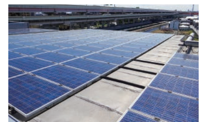
東京FSセンター屋上の太陽光パネル
